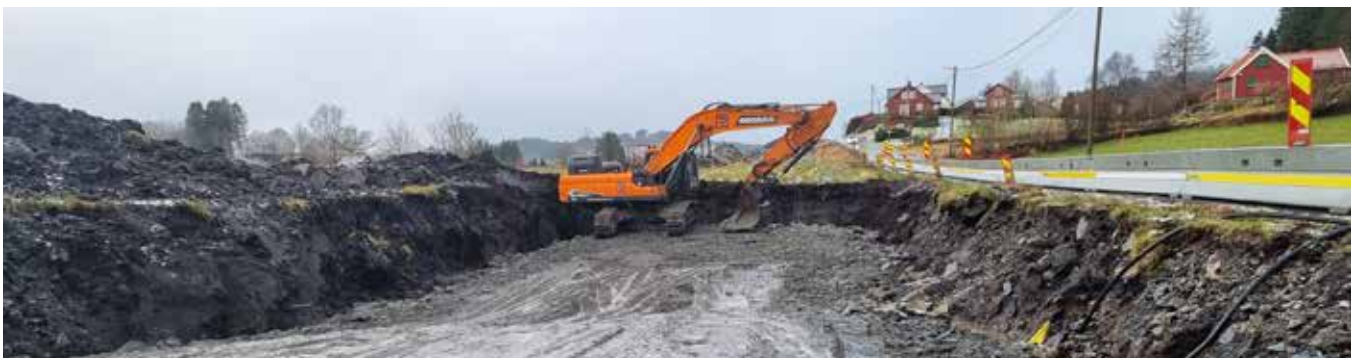
Arbeidet med ny trafiksikker infrastruktur i Sagstadvegen starta opp i 2023. Foto: Vestland fylkeskommune
